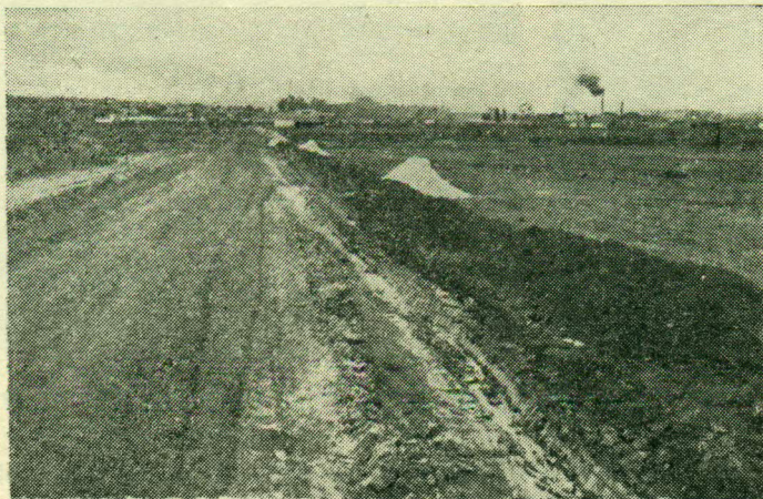
Fig. 5. — La carretera antes de la estabilización
