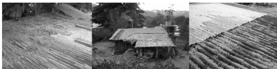
Figura 11. Los efectos de la ceniza en los techos de chapa de cartón. Villa La Angostura, Neuquén. 2011. Fuente: gentileza del Comando de Operaciones en Emergencias (COE) de Villa La Angostura.
