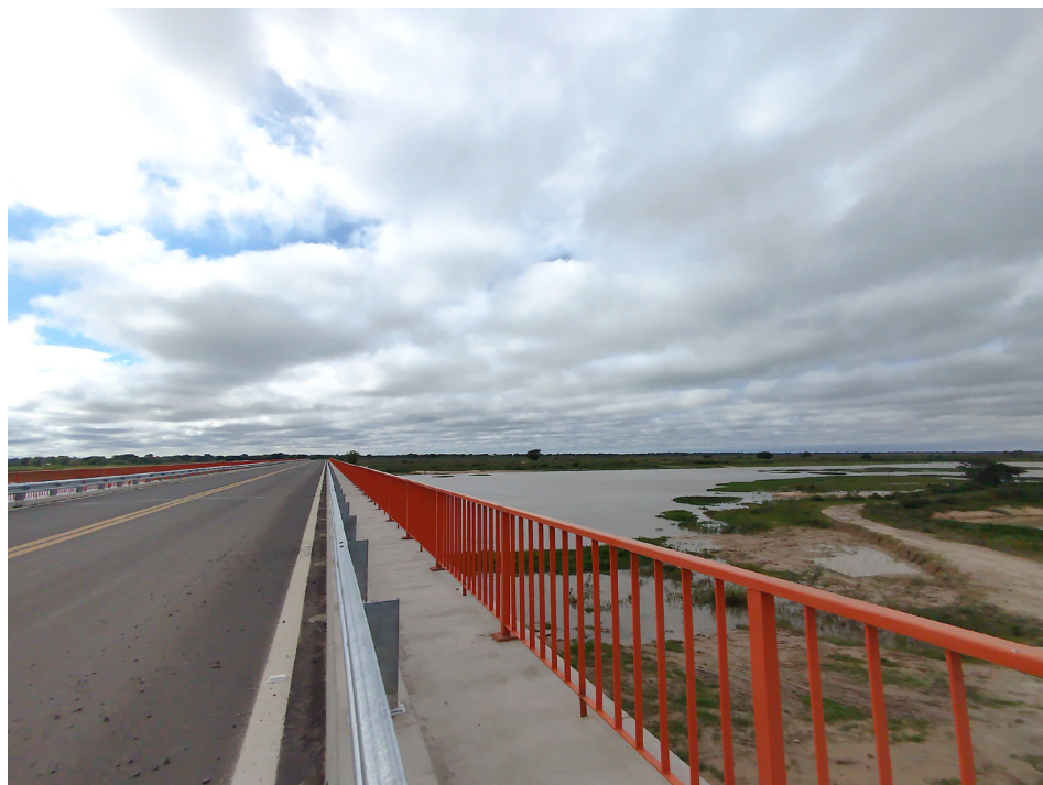
Figura 2. Puente construido sobre el Paraná Mini. Fuente: fotografía propia tomada durante el trabajo de campo, Villa Ocampo, mayo 2025.
